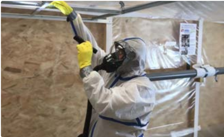
Intervention d'un expert amiante certifié - Crédit photo : Acceo
